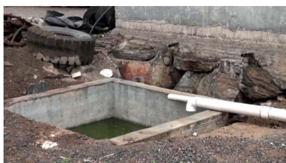
生活污水收集池
