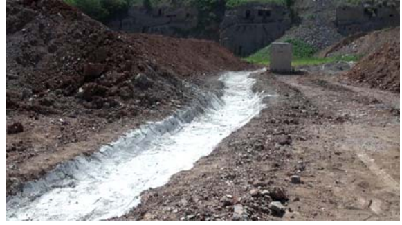
1#排土场截排水沟
