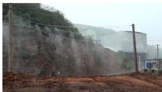
厂区道路喷淋网
