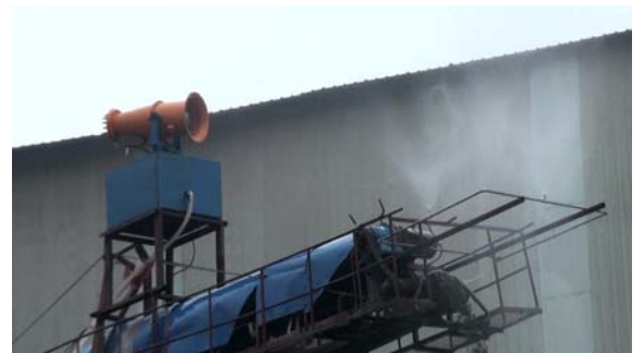
输送皮带落料口及喷水装置和雾炮
