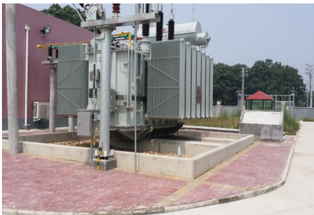
变压器及集油坑
