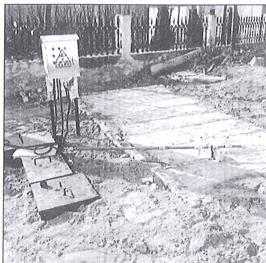
一体化污水处理设施 1 套及蓄水池 1 座
