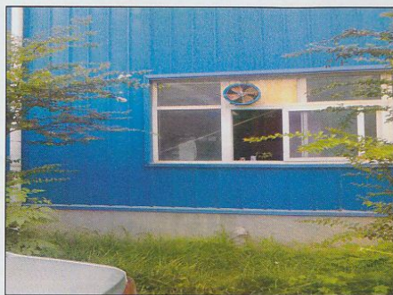
2号生产车间排风扇
