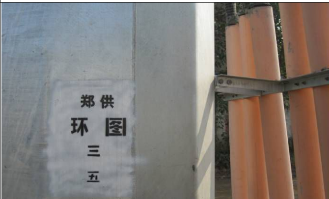
电缆出线塔标 2
