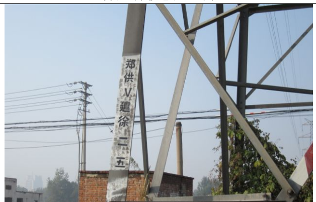
220kv新建线塔标
