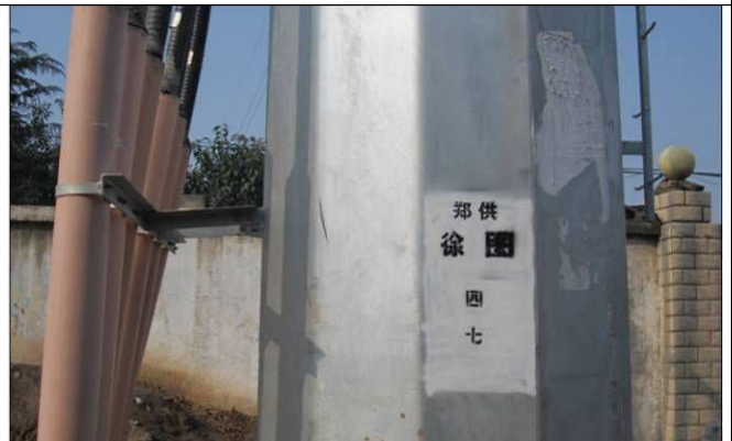
电缆出线塔标 1
