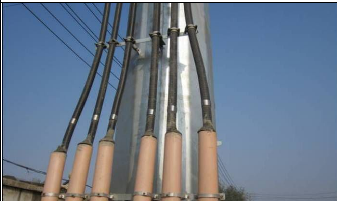
电缆出线情况
