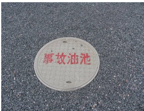
站内事故油池
