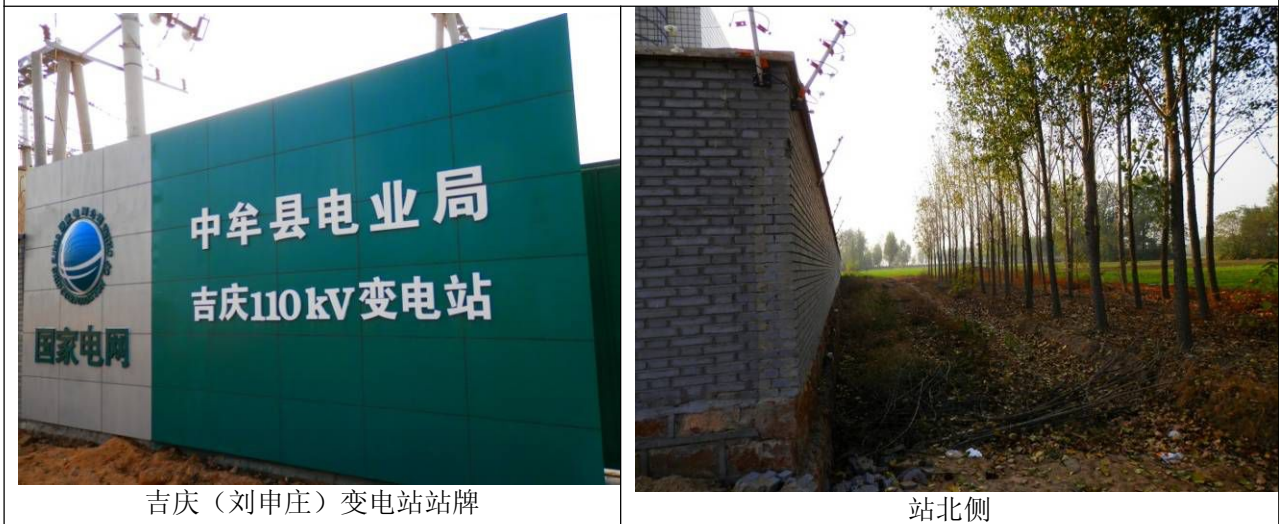
110kV 吉庆（刘申庄）变电站周边图片
