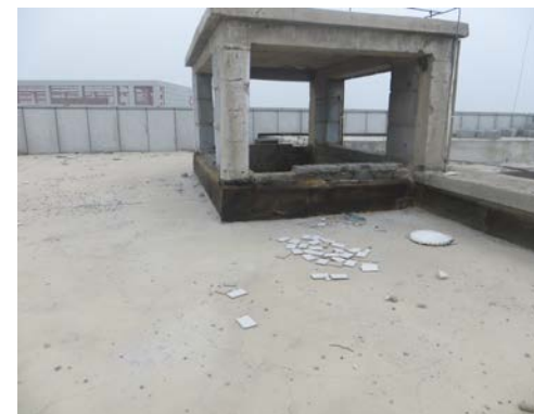
直燃机排气口
